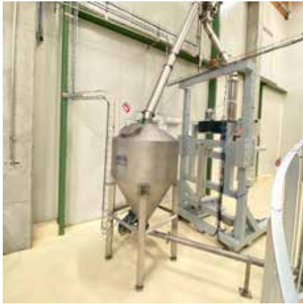
→ En sortie de stabilisateur, la spire alimente soit une trémie tampon reliée au broyeur soit une station de remplissage de big-bag.
