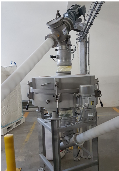
Alimentation et reprise sous tamiseur
