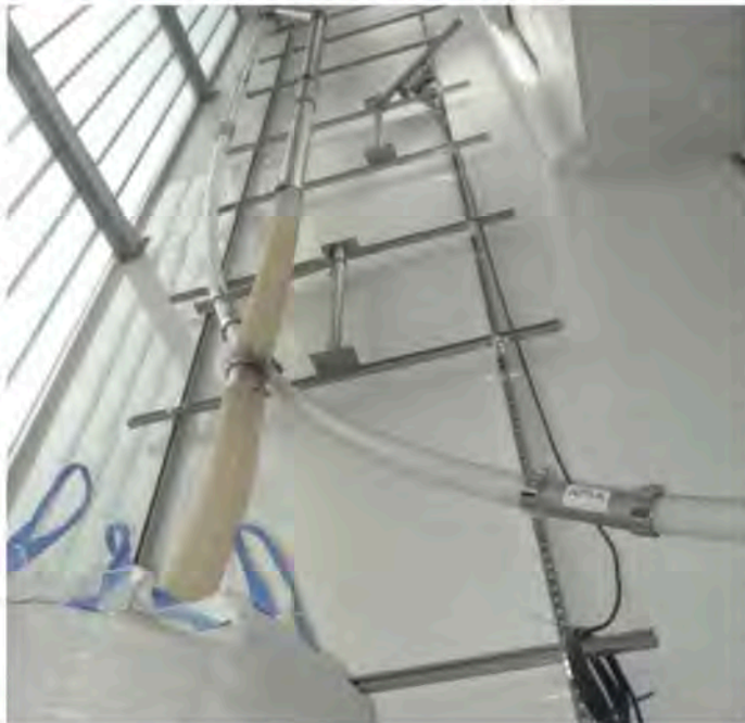
| Station d'essai d'APIA Technologie.
