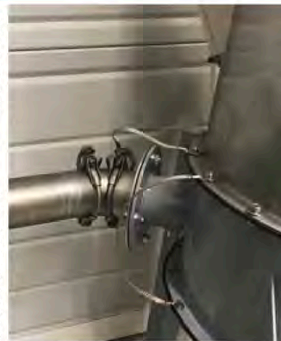
Zoom sur les raccords et tresse de mise à la terre.
