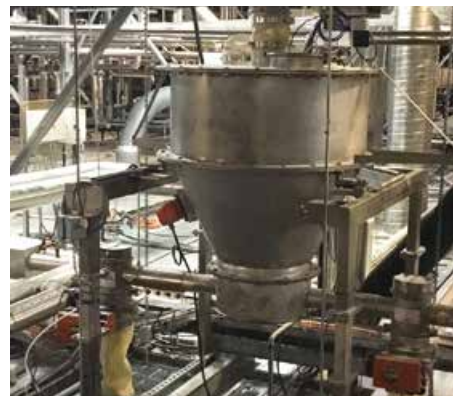
▷ La trémie pesée implantée dans les combles, dose et alimente les 2 mélangeurs.
