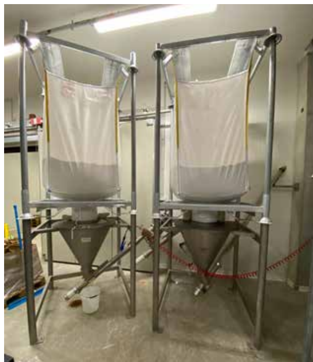
→ 2 stations de vidange big-bag équipées d'embases fixes et de cadres manutentionnables par gerbeur ou par chariot permettent l'alimentation des lignes de conditionnement.
