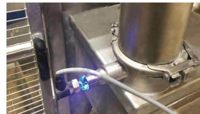
Détecteur de niveau sur farneur.
