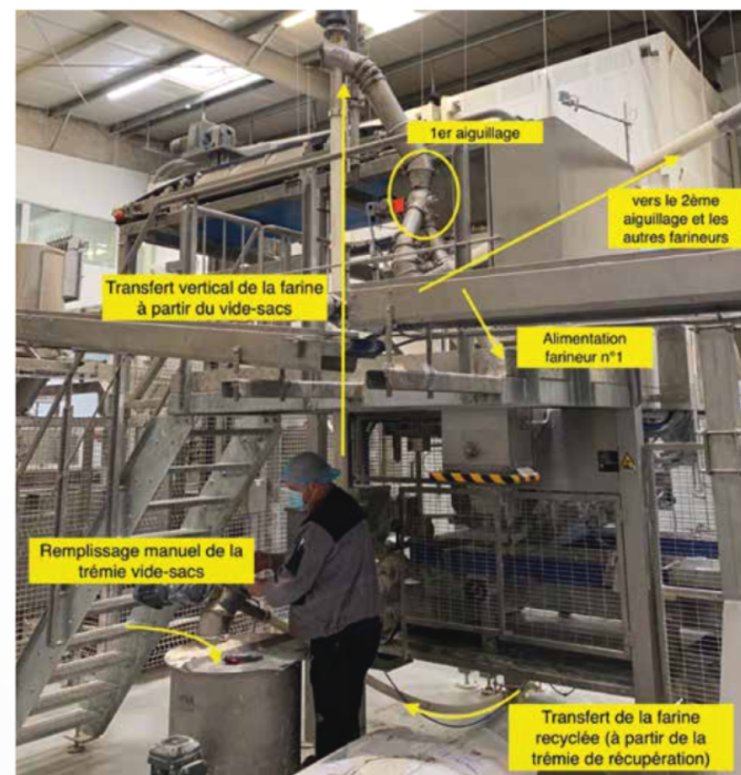
Explication du fonctionnement de la ligne de panification.
