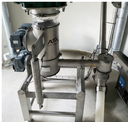
Reprise sous silo avec égrugeonneur
