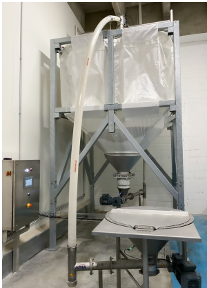
Trémie vide-sacs vers silo
