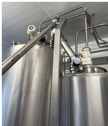
Aiguillage vers les cuves de mélange
