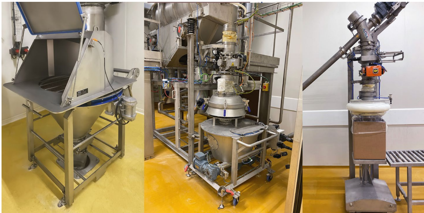
Lutte contre les corps étrangers en amont (vide-sacs avec grille de sécurité), en ligne (tamiseur) et en aval (piège magnétique).
